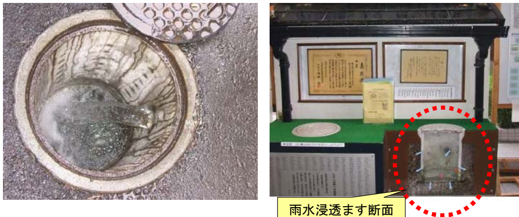
雨水浸透ますの例
