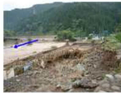
落橋した越美北線橋梁と被災した堤防の状況（福井市安波賀）
