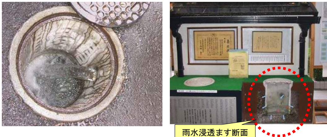
雨水浸透ますの例
