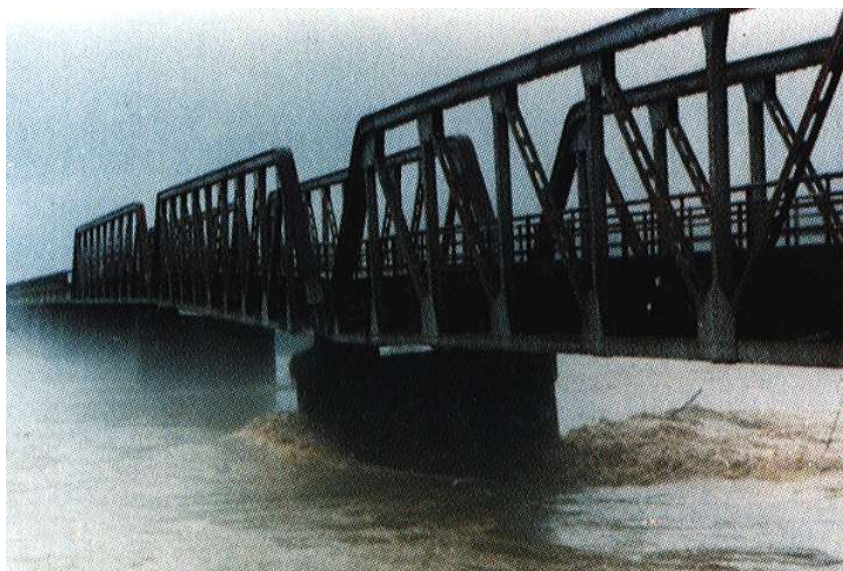
昭和56年7月洪水（梅雨前線） 洗掘により傾いた高屋橋（県道福井三国線）の橋脚
