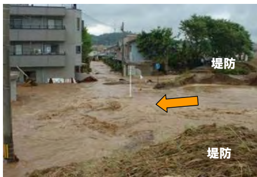
平成16年7月福井豪雨 足羽川の堤防の決壊状況(福井市春日)
