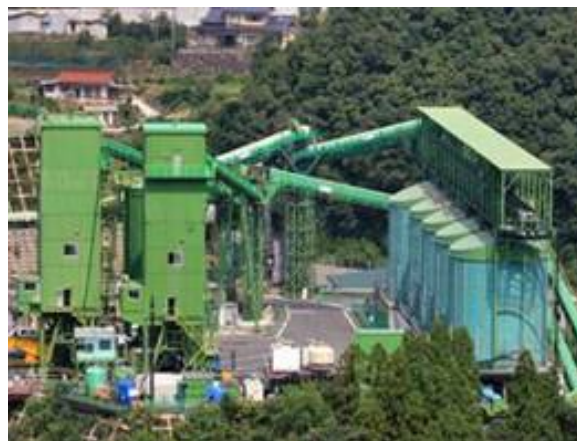
コンクリート設備全体写真（他ダム事例）
