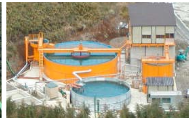
濁水処理施設（他ダム事例）
