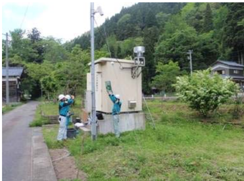
雨量観測所写真（設置状況写真）
