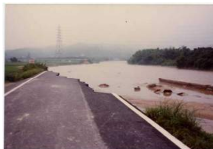
写真 2.2-5 大津市上田上の道路被害
