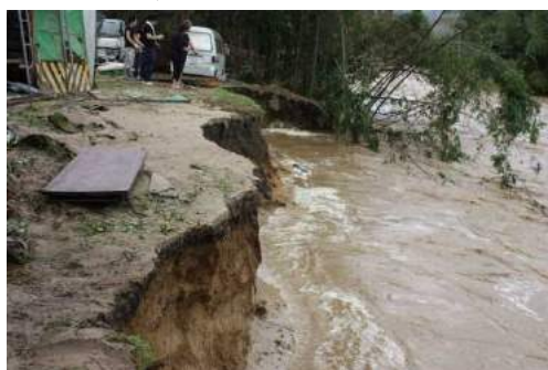
写真 2.2-6 大津市石居の河岸洗堀
