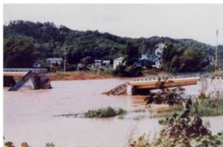
写真 2.2-4 大津市石居の橋梁流出
