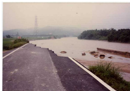
写真 2.2-5 大津市上田上の道路被害
