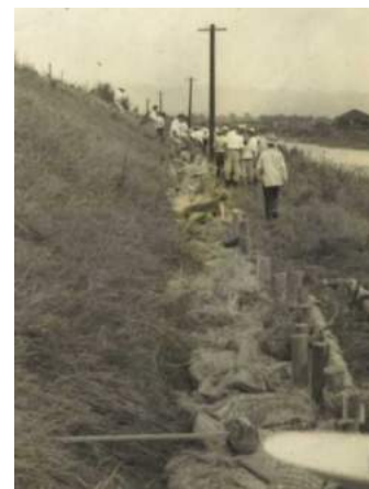
写真 2.2-3 京都府久御山町の堤防漏水・裏法崩れ
