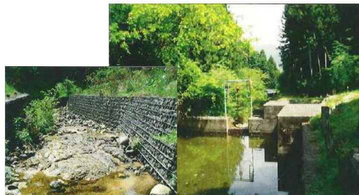
写真 2.3-1 経年的に流況が悪化し、効率が低下した水源（朝古川水系木落川）
