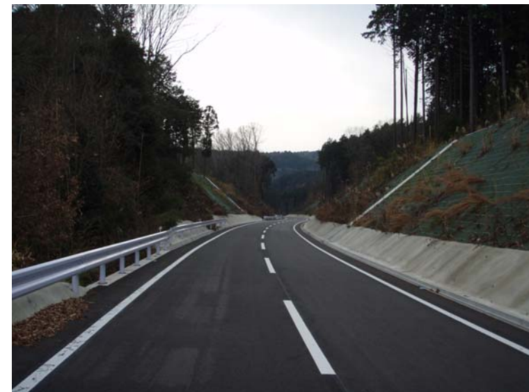
写真③ 付替県道青山美杉線 (H22. 2. 10 一部供用開始) H22.1撮影
