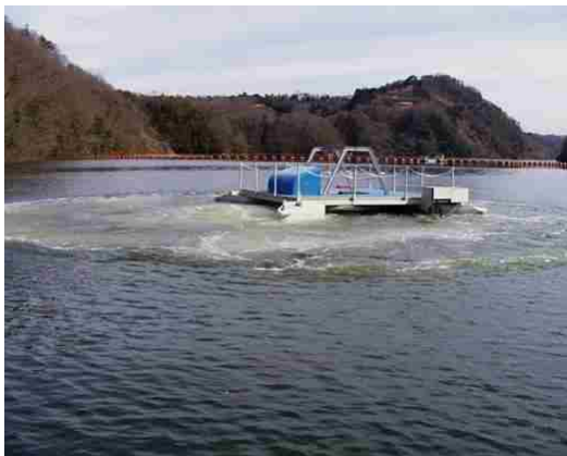
曝気循環設備
