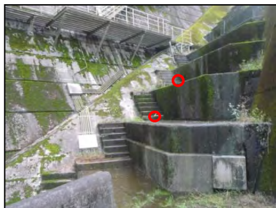
ヌートリアの糞の確認場所（ダム堤体付近）
