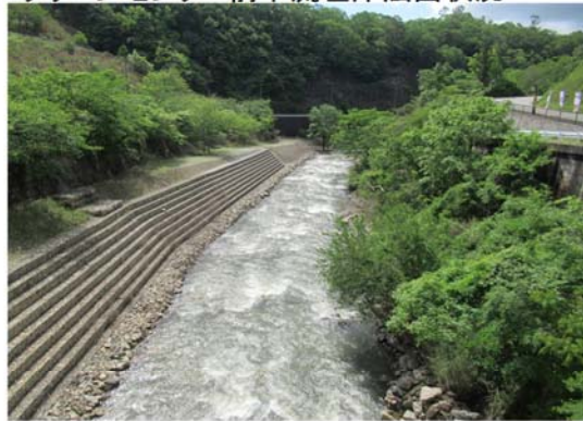
⑩ クリーンセンター前下流左岸法面状況
