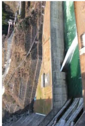
利水放流設備
