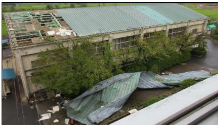
体育館屋根の損傷
