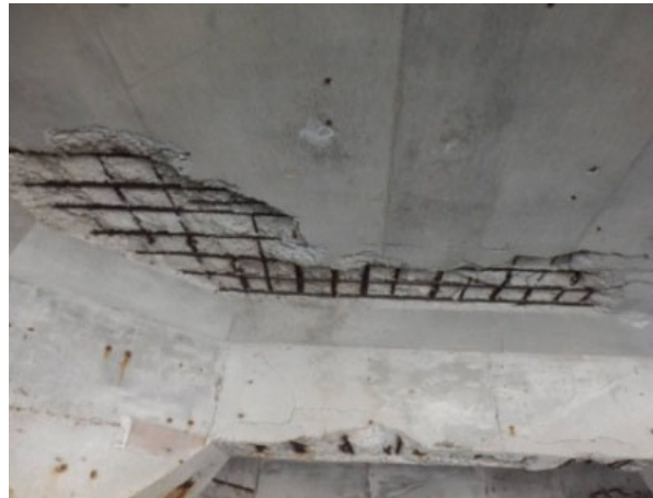
【上部工のコンクリート剥離、鉄筋腐食】
