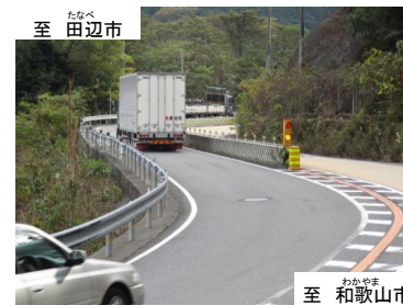
写真③ 平面線形不良箇所
