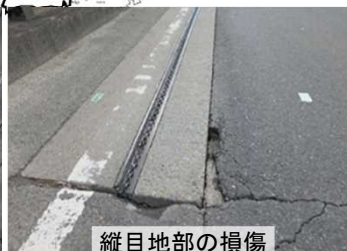
縦目地部の損傷
