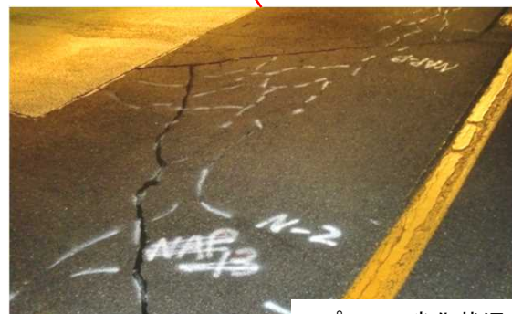
エプロンの劣化状況
