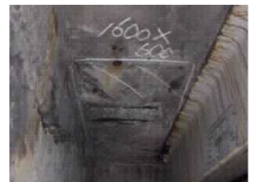
床版の鉄筋露出
