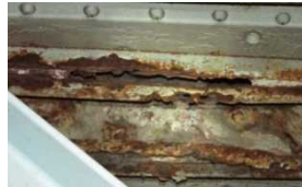
トラスの腐食
