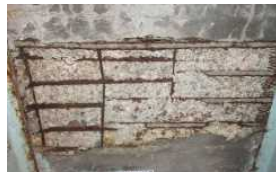
床版の剥離・鉄筋露出
