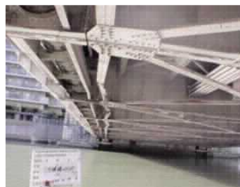
床組の劣化損傷
