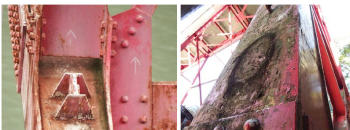
鋼部材の防食機能の劣化状況
