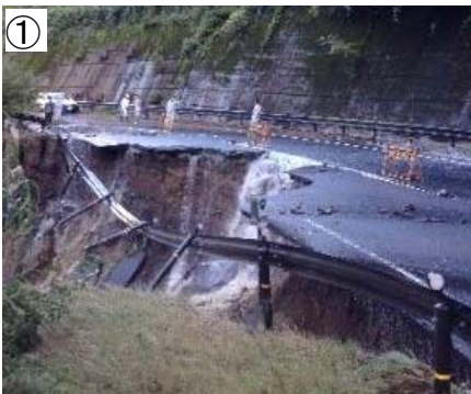
① 路肩決壊状況 (H25.9 五條市西吉野町西野)
