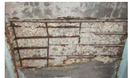
床版の剥離・鉄筋露出
