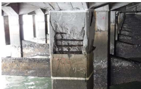
【脚柱部のコンクリート剥離、鉄筋腐食】
