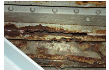
トラスの腐食
