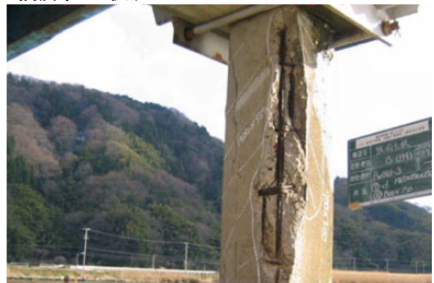
コンクリートが剥離し鉄筋が露出
