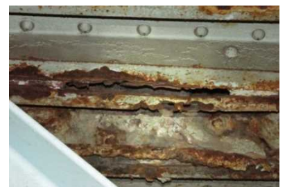
トラスの腐食
