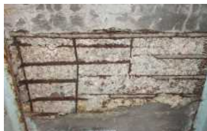
床版の剥離・鉄筋露出
