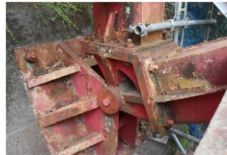
▲支承との取付ボルトのナットに欠け(減肉)
