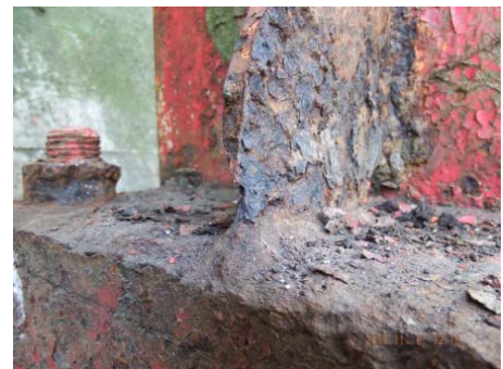
▲アーチ基部の補剛材の断面減少
