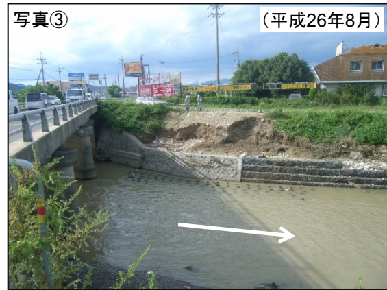
堤防法面の崩壊
