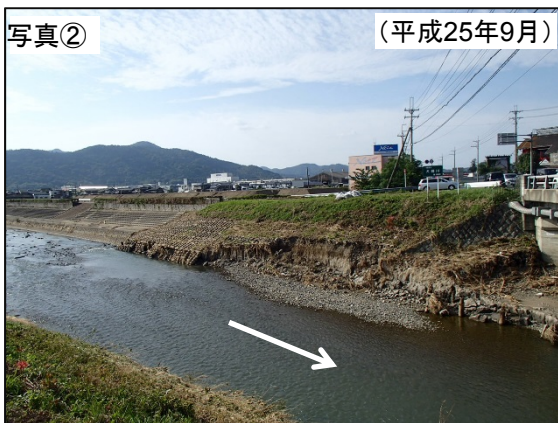
堤防法面の崩壊及び根固め工の流出
