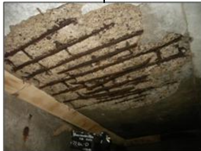
床版のコンクリート剥離、鉄筋腐食
