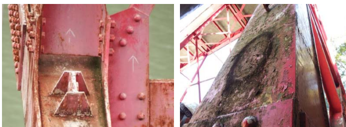
▲鋼部材の防食機能の劣化状況
