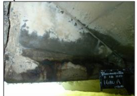
梁のコンクリートひび割れ、錆汁
