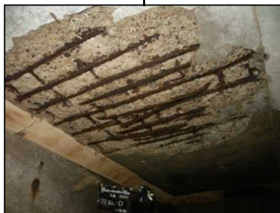
床版のコンクリート剥離、鉄筋腐食
