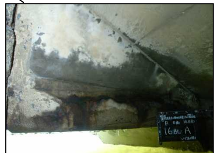
梁のコンクリートひび割れ、錆汁
