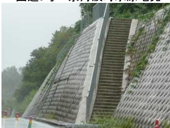
擁壁変状により 全面通行止め (H23. 9)
