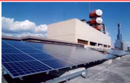
太陽光発電設備
