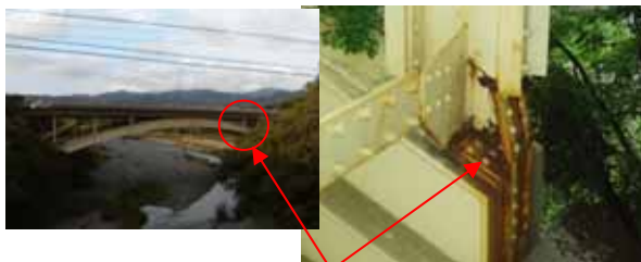
アーチ端支柱部材の腐食
