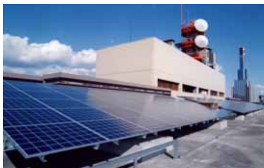
太陽光発電設備
