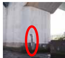
コンクリート剥離状況
