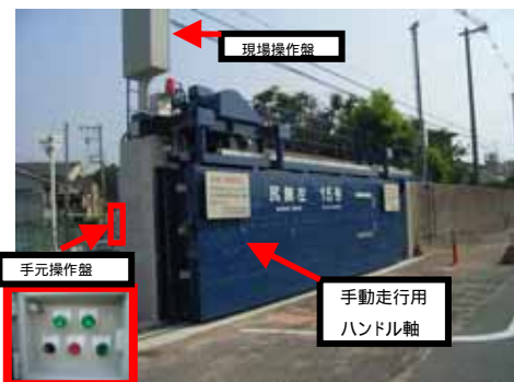
電動化後の防潮鉄扉
