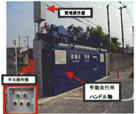
電動化後の防潮鉄扉
