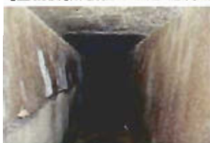
【整備前】耐震性の不足・老朽化
