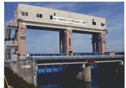
水門自動急閉装置(H18.3完成) (市田川水門<熊野川>) 地震発生約10分後の津波第一波到達に対し、7分程度で水門を自動閉鎖
