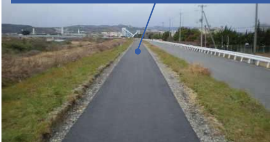
危機管理型ハード対策(堤防天端舗装)
