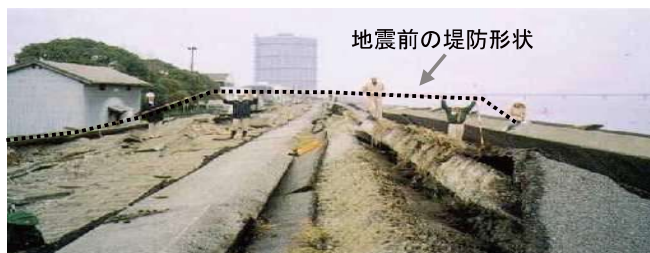
阪神・淡路大震災における西島地区の堤防被害状況 (平成7年1月撮影)
