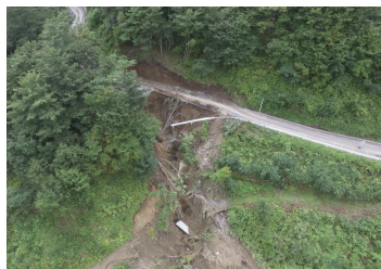
ドローンによる被災状況調査 (平成28年9月台風10号東北豪雨)
