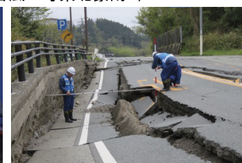
道路被災箇所の調査 (平成28年4月熊本地震)
