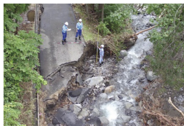
道路被災箇所の調査
