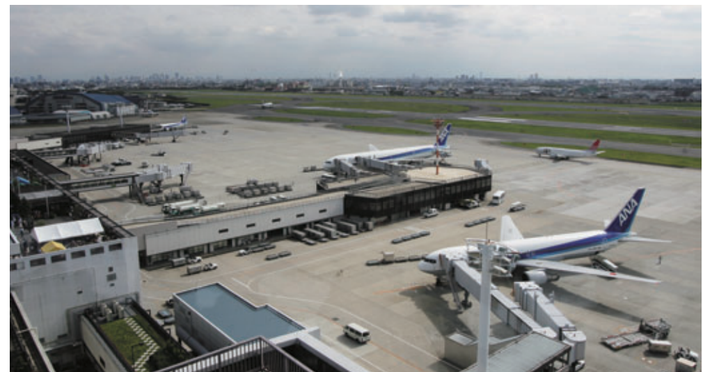
エプロンの改修工事が始まった大阪国際空港（整備開始前）
