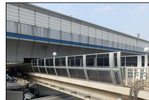
① 歩道橋本体に設置されている防音パネルは近接する高架橋橋桁と整合を図りグレーで整備
