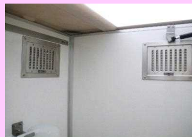
⑯『室内温度調節機能』の設置
