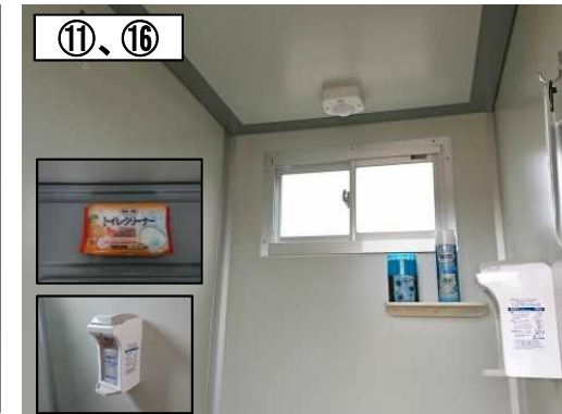
室内温度調節設備(窓) 便座除菌クリーナー等の衛生用品
