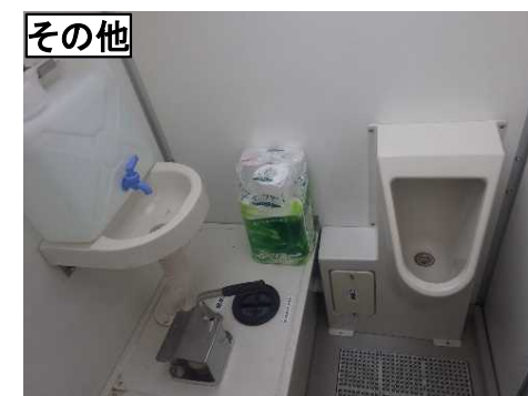
⑭ その他 小便器設備
