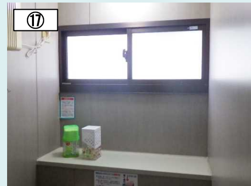
窓の開閉により 換気や室温調整が可能
