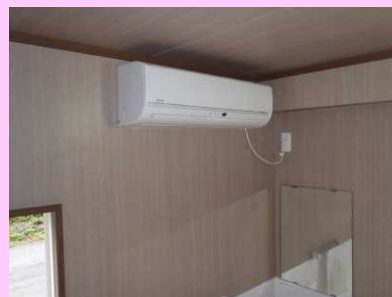
⑯室内温度調整設備
