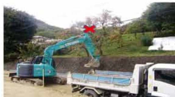
単粒碎石をバックホウでダンプトラックから積み下ろす際に旋回中にNTT架空線に接触した。
