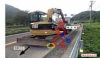
事故状況写真②
