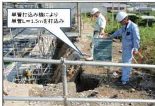
事故状況写真
