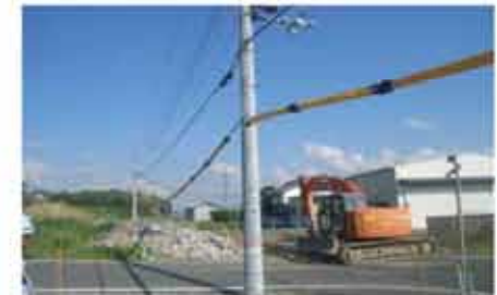
事故状況写真②
