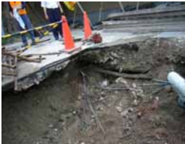
被害状況写真
