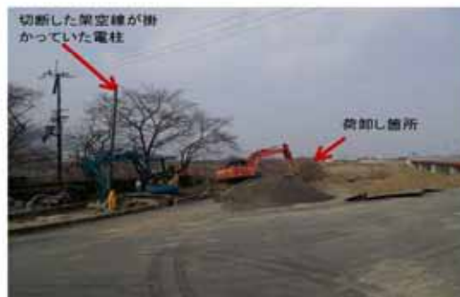
事故状況写真
