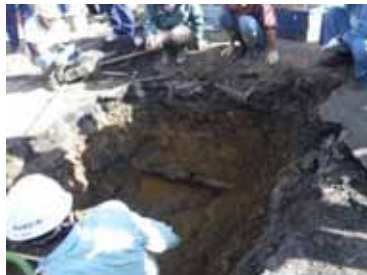
被害状況写真
