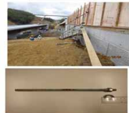
事故状況写真②
