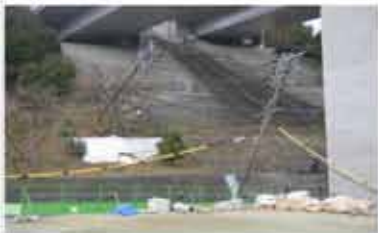
関西電力柱2本が半倒壊
