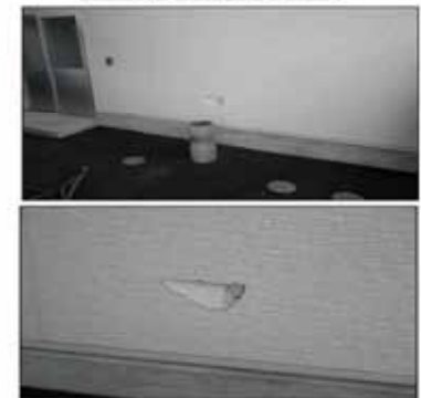
事故状況写真②
