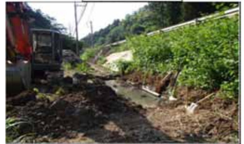
事故発生状況写真
