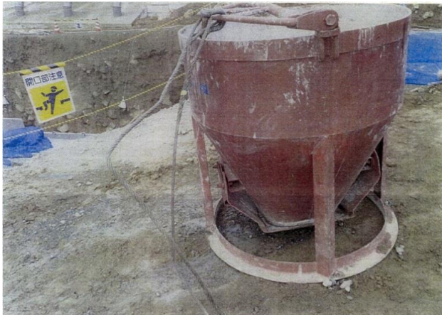
クレーンのワイヤーが切れ、上の写真に示すコンクリートバケットが落下
