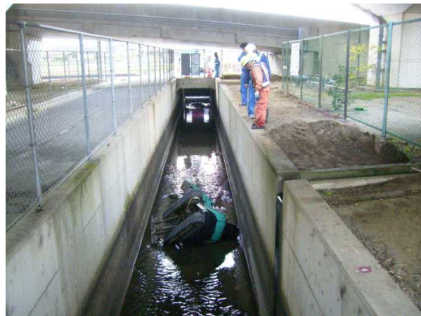
掘削作業中に水路に転落した
