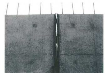
擁壁が傾いたことによる目地のすき間
