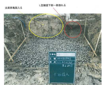
床堀ラインが既設擁壁に影響
