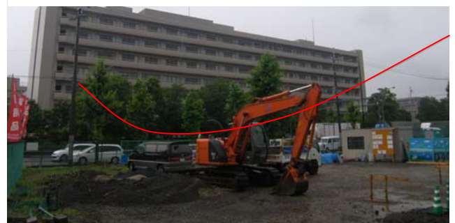
事故状況写真
