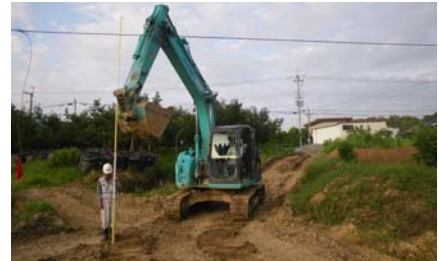
事故状況写真
