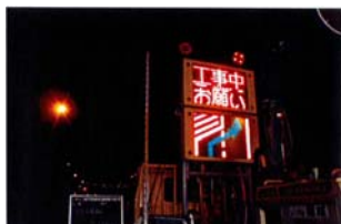
大型電光掲示板を高い位置に設置
