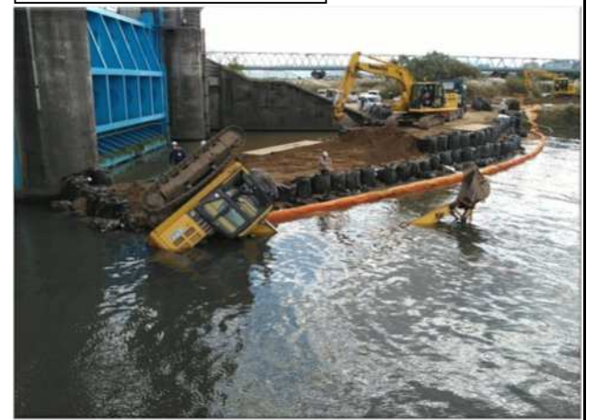
事故状況写真②
