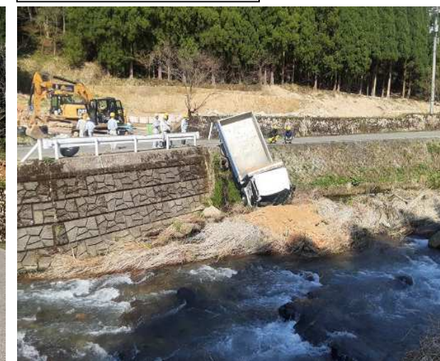
事故状況写真②
