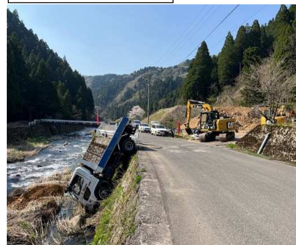
事故状況写真①
