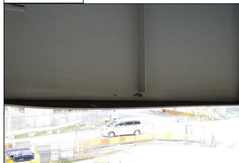
事故状況写真②
