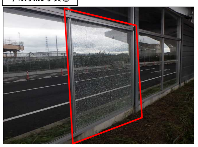
赤線内 ※遮音壁(ガラスタイプ) [破損後]
