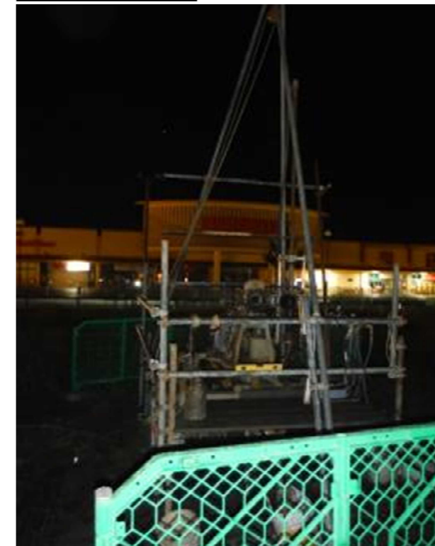
地表状況: 下水管損傷箇所の地表部
