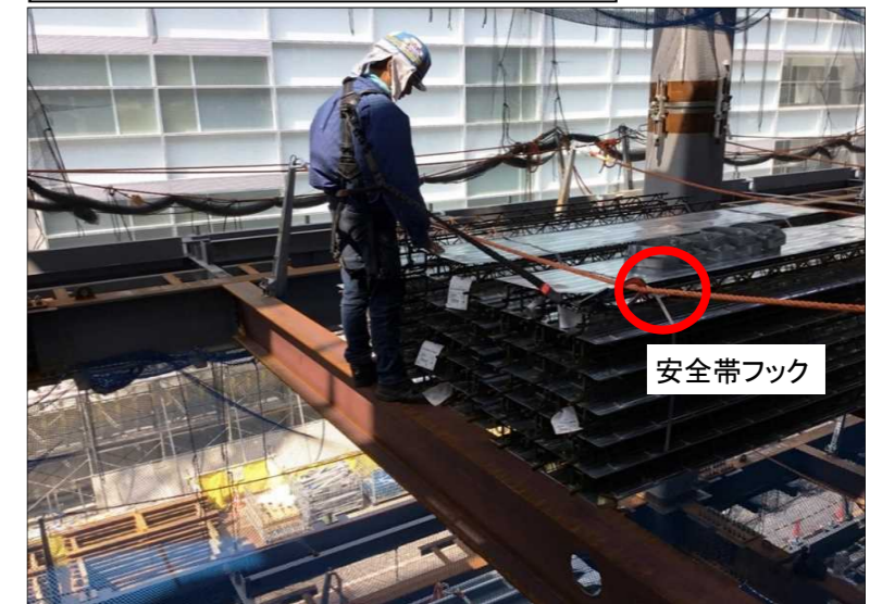
事故状況写真② (事故再現写真)
