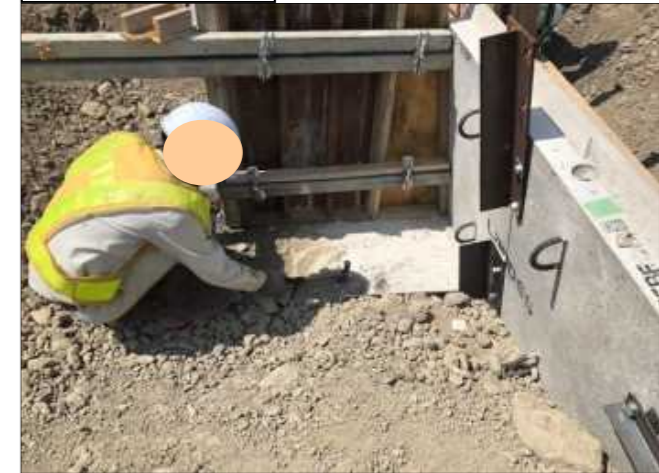
事故状況写真②
