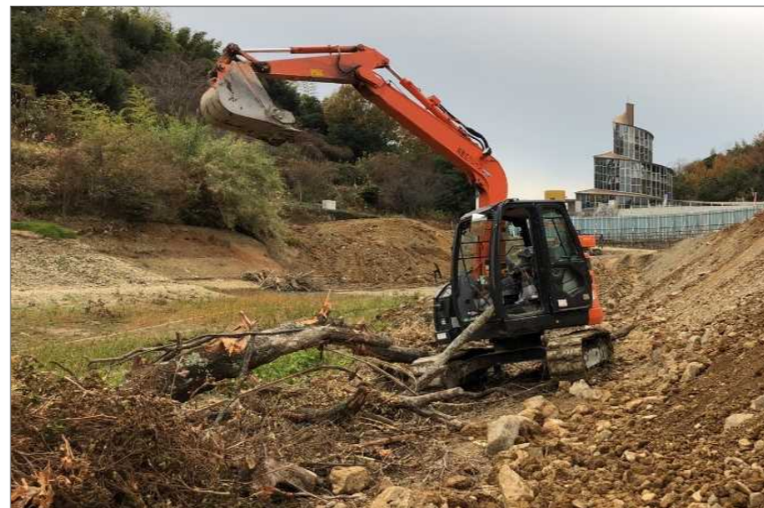
事故状況写真②
