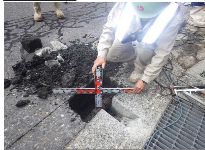
事故状況写真①
