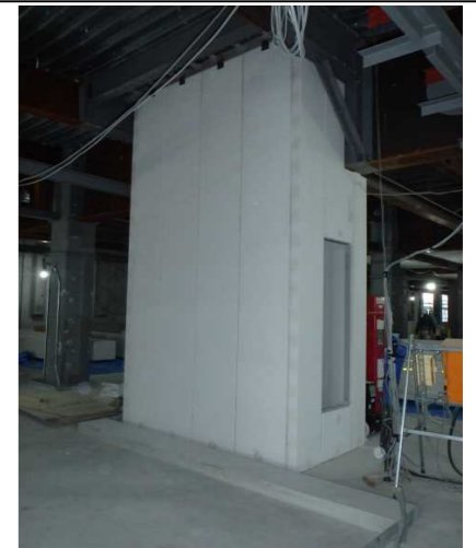
事故状況写真③ (避圧ダクトスペース ALC板建て込み後)
