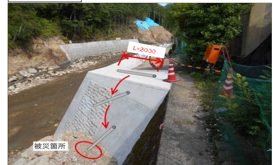
事故状況写真②
