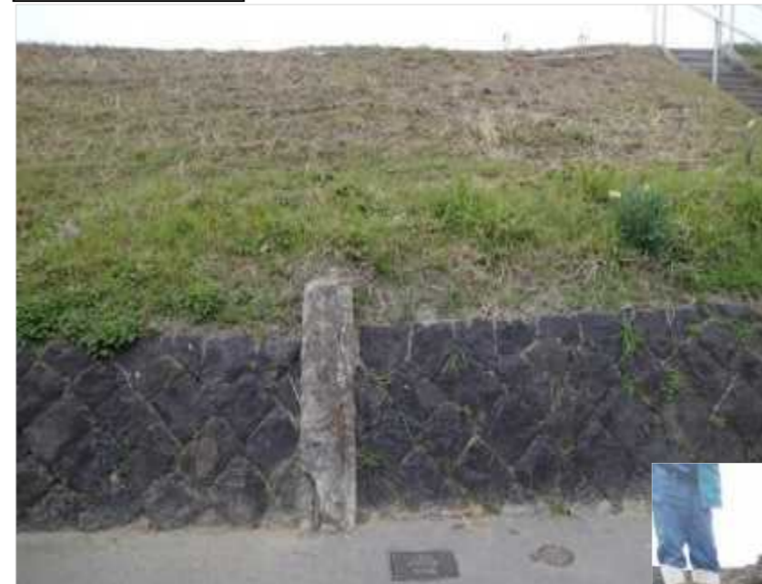
事故状況写真①
