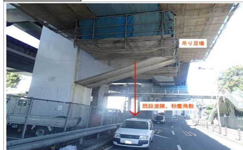
事故状況写真①
