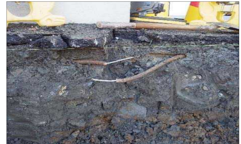
事故状況写真②
