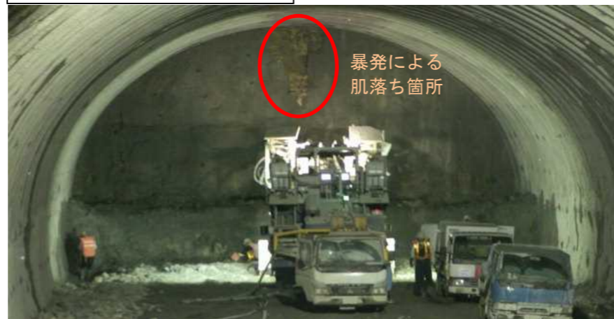
事故状況写真② (暴発直後)
