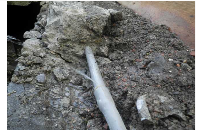
事故状況写真②
