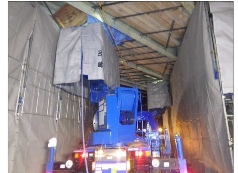
事故状況写真② 作業状況の全景
