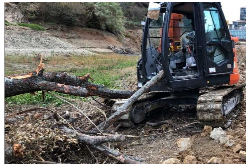
事故状況写真③
