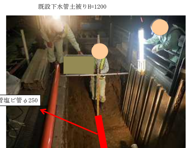
事故状況写真②
