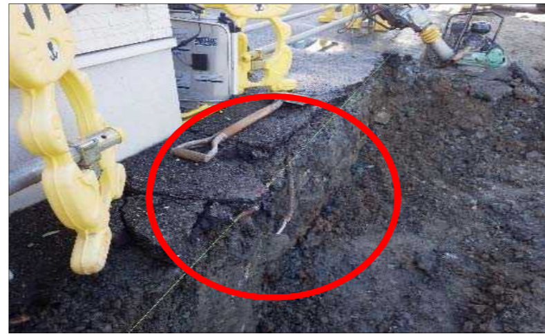
事故状況写真①(被害状況(電線管及び電線切断))
