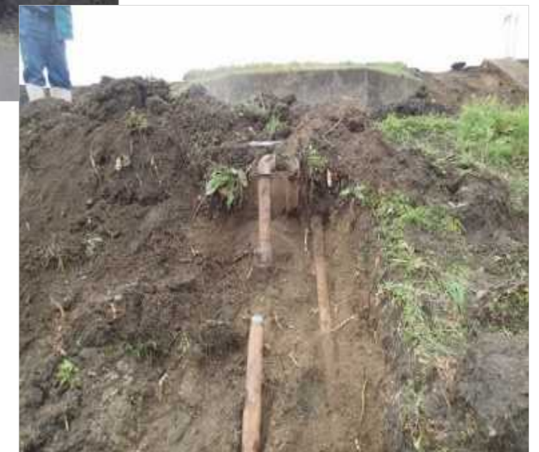
事故状況写真②
