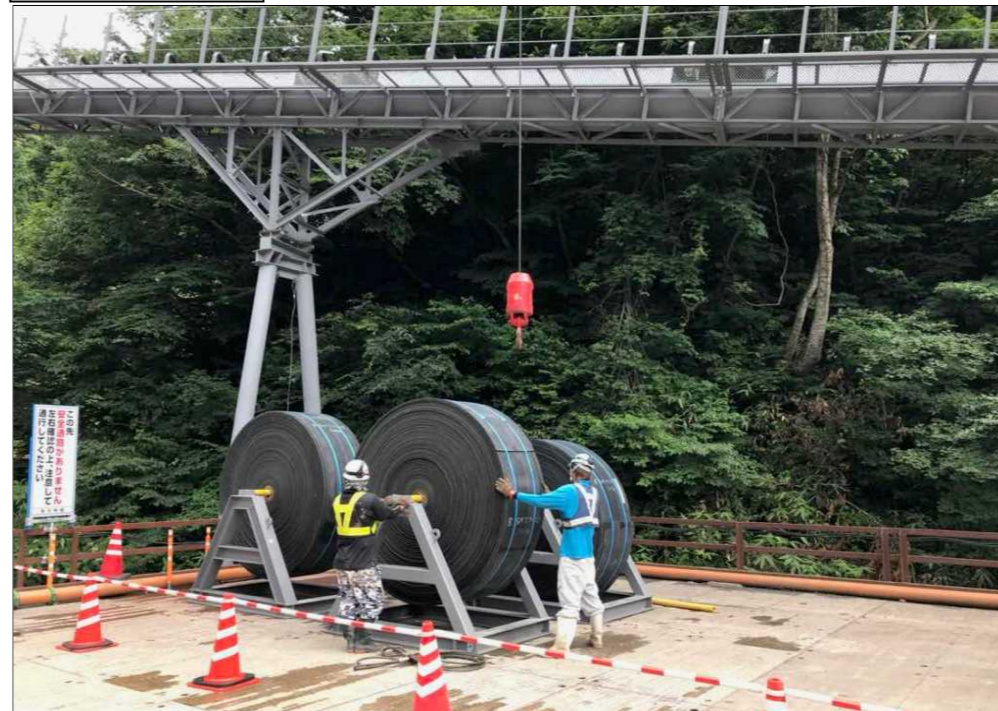
事故状況写真①
