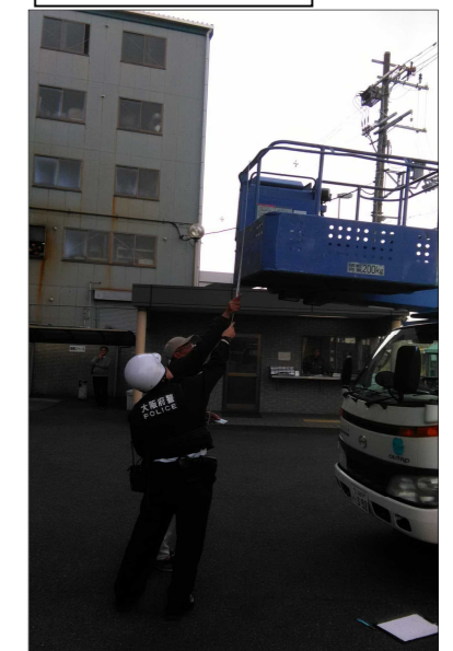
事故状況写真③
