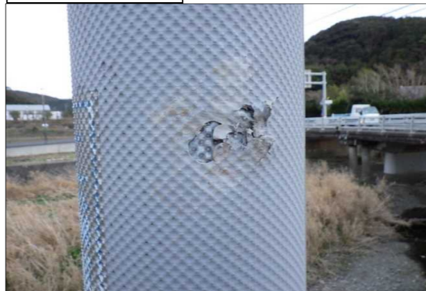
事故状況写真②
