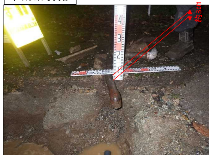
事故状況写真②
