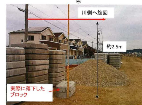
2個吊っていたブロック(180kg/個)の上の1個がバランスをくずし、約2.5mの高さから落下
