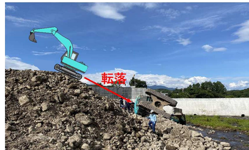
図 事故状況写真
