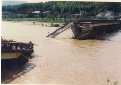
石居橋の流出
