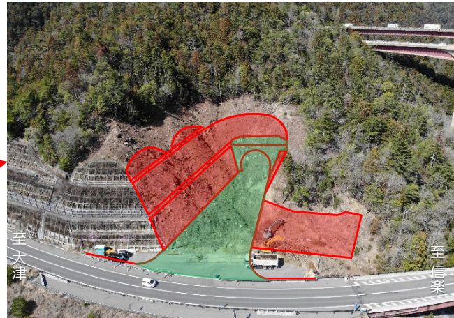
法面对策 現地状況 (令和8年3月時点)
