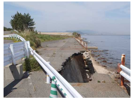
公園区域陥没の例
