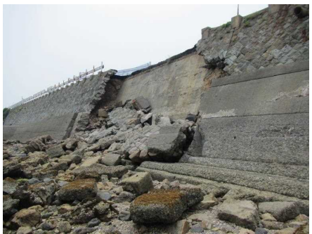
護岸洗掘の例
