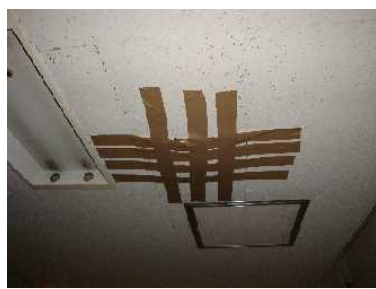
【老朽②】 ← 雨漏りで天井落下
