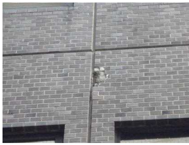
【老朽④】 ← 外壁タイルの剥落
