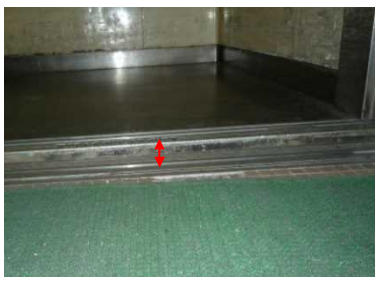
【老朽①】 ← EVの段差
