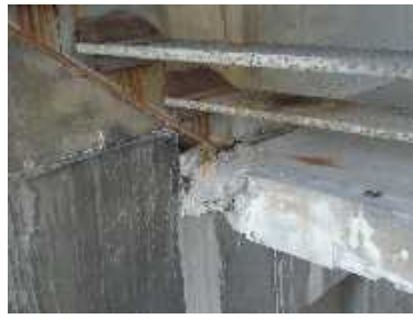
【老朽③】 ← 避難階段の劣化
