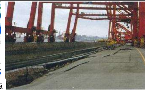
阪神・淡路大震災で被災した神戸港六甲アイランドRC3
