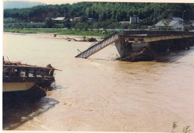
石居橋の流出
