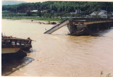
石居橋の流出
