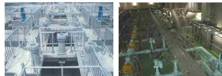
ゆめが丘浄水場(稼働中)
