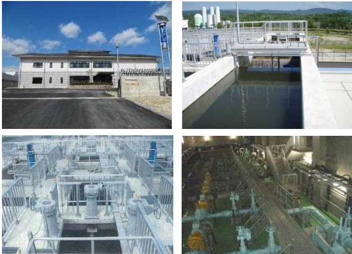
ゆめが丘浄水場(稼働中)
