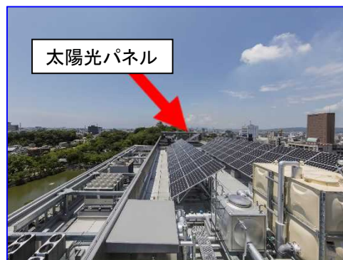
太陽光パネル (屋上)
